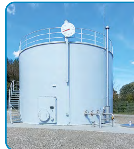
In diesem Gasbehälter wird das in der Schlammfau-lungsanlage erzeugte Methangas zwischengespei- chert und anschließend im Blockheizkraftwerk als Brennstoff verwendet.
